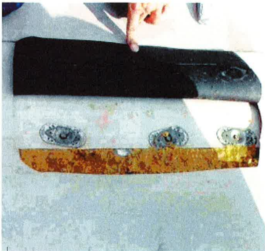
Figuur 2: Beschadiging van dakbedekkingsmateriaal als gevolg van het bezwijken van de isolatie door frequent belopen: de schroefkoppen van de mechanische bevestiging hebben de PVC-bedekking geperforeerd.
