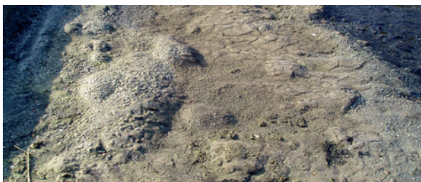
Stilstaand water kan de dakbedekking ernstig beschadigen
